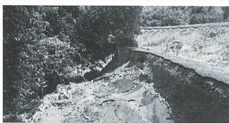
改良区管理用道路崩落現場（勝央町内）
