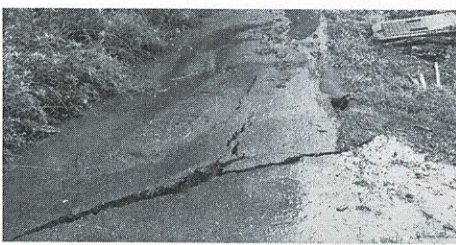
勝田水路管理施設道路崩落現場（美作市内）
