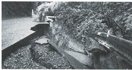
西原ダム管理用道路崩落現場（奈義町内）
