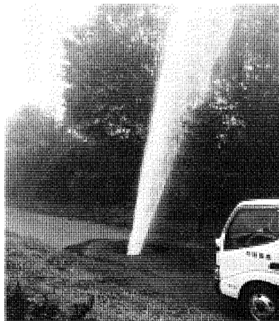
◀東部水路漏水 (φ450mm) 水柱となって10m以上噴き上げる
